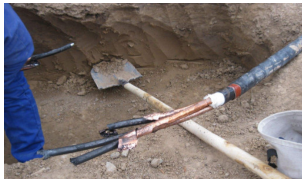
图 8 埋地电缆外破事故现场
