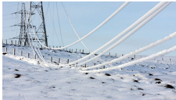
图 5 架空输电线缆覆冰图
